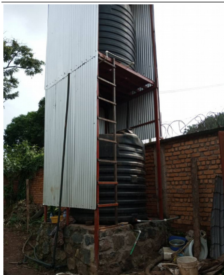
Akvoturo kun filtrado kaj disinfektado
